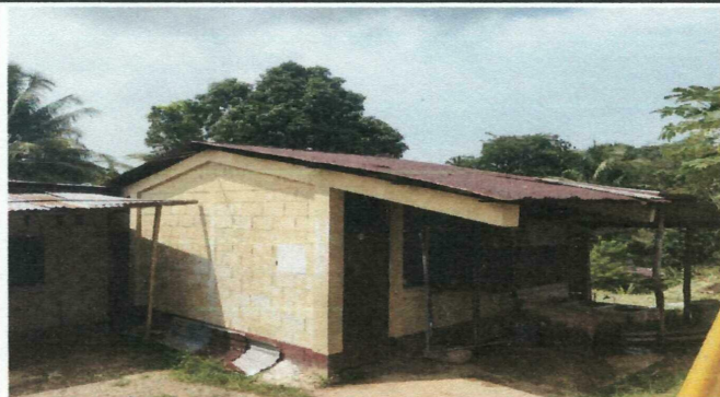
Foto 1: Se observa el deterioro de la cubierta de lamina del modulo de cocina del centro educativo.
