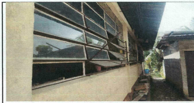
Foto 4: Vista de las ventanas deterioradas del modulo de aulas, se sustituirá también la estructura y cubierta de lamina.
