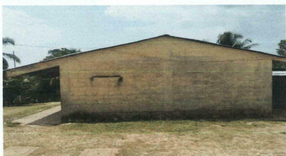
Foto 1: Se observan las paredes exteriores deterioradas por lo que se aplicará pintura en muros interiores y exteriores.
